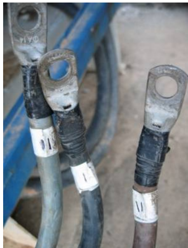
Detalle del marcado de los cables
