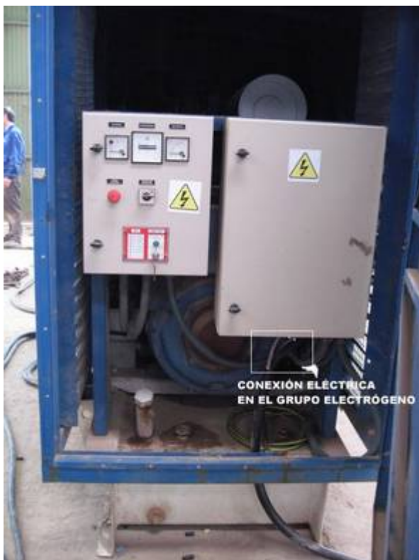
Conexión en el grupo electrógeno
